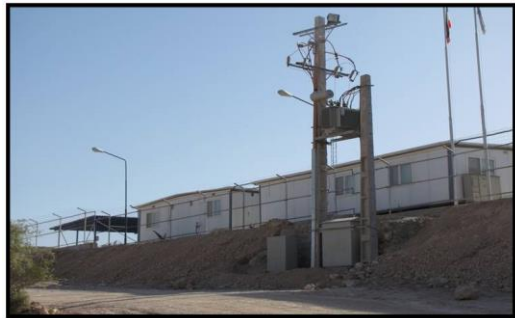
نصب ترانس و برقدار شدن کانکس های اداری
