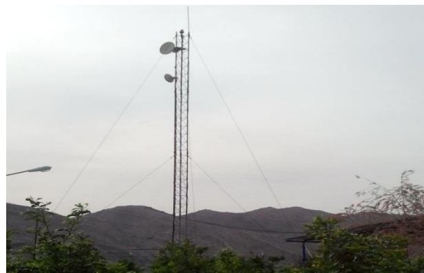
نمایی از تجهیزات مخابراتی نصب شده در سایت (جهت اتصال به خطوط جدید تلفن و اینترنت سایت)
